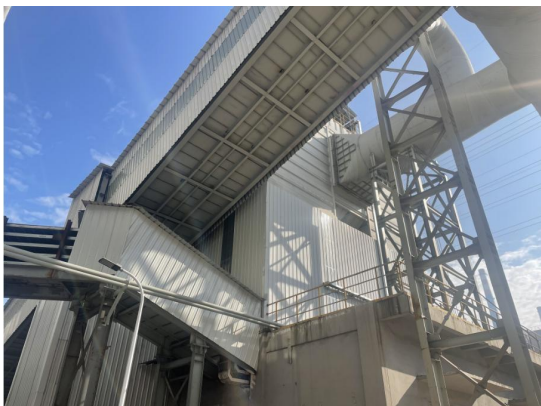
配料废气处理设施
