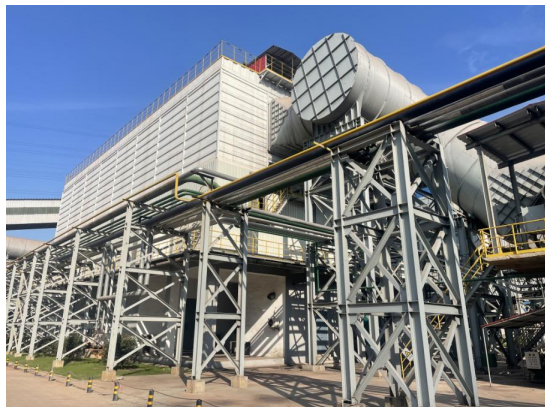
烧结机尾、环冷机、成品筛分室废气处理设施
