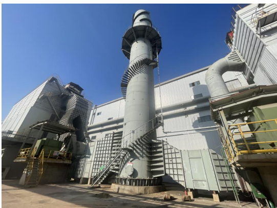
配料、燃料破碎废气排气筒
