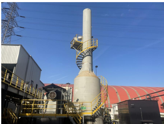
混合废气处理设施及排气筒
