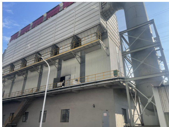
燃料破碎废气处理设施
