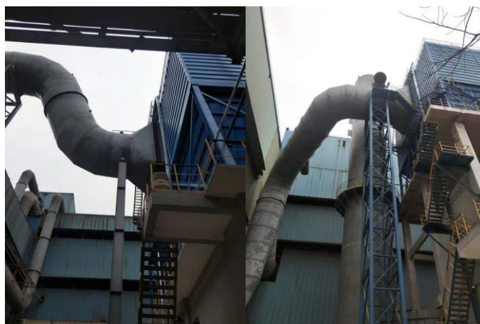
图 8-3-1 转炉三次除尘进口（左）3#转炉二次除尘（右）
